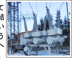
ガス絶縁開閉装置(下部の円筒部分)
